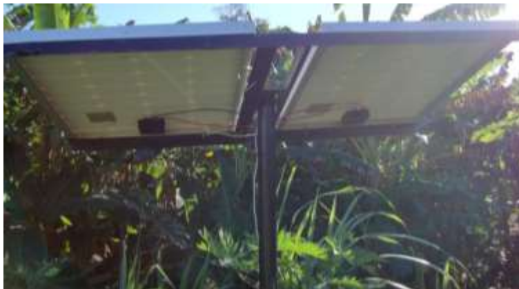
Estructura de Paneles Solares
