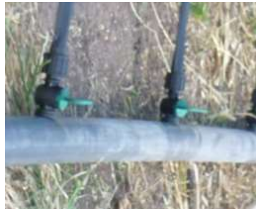
Acople de Tubería y Cintas
